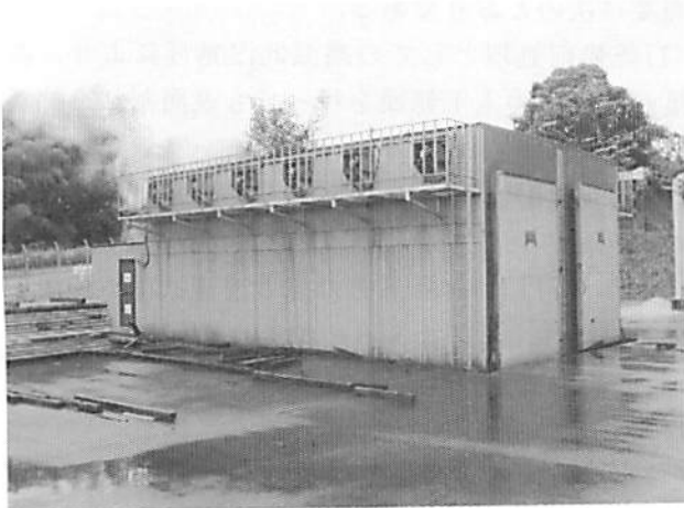
図2-1 高温蒸気式乾燥機
